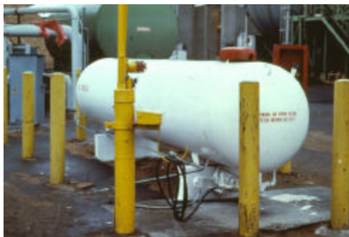
El tanque de propano usado para rellenar el tanque del montacargas está protegido por postes pesados en caso de daños por parte del vehículo.
